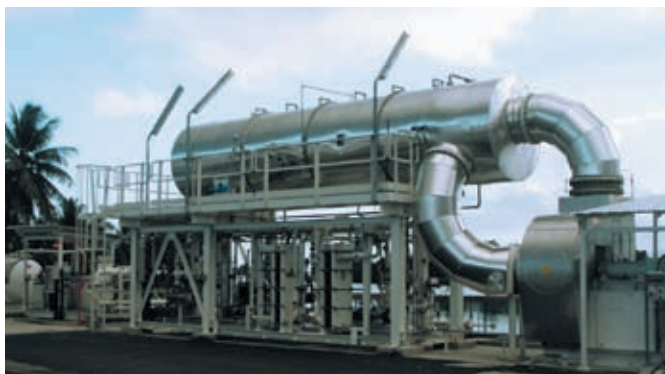
Compressore di vapore Piller in un dissalatore di acqua di mare
