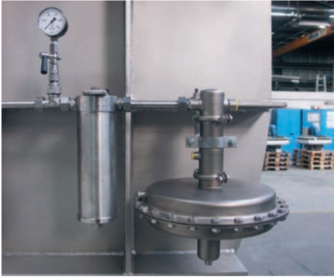
Unità di regolazione del fluido barriera e di filtraggio del vapore
