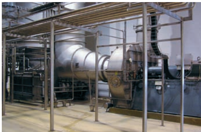
Compressore di vapore nell'industria del latte
